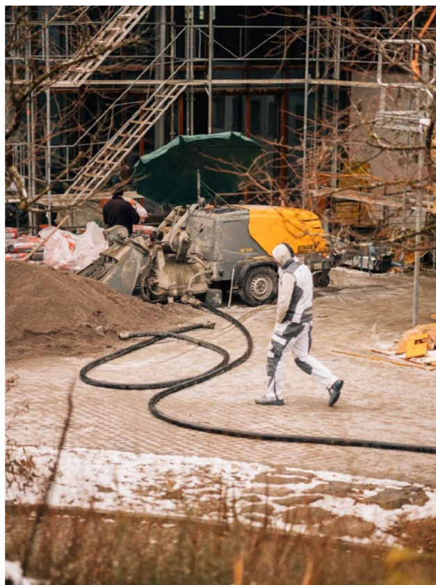
Der Arbogaster Hof war im Winter durch die Bauarbeiten kaum wieder zu erkennen.
